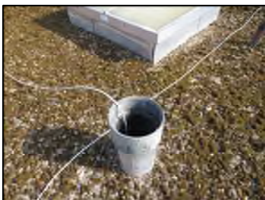
Photo N° 597 AMIANTE CIMENT -- Toiture terrasse Conduits de fluide Ventilation haute (Fibres-ciment)
